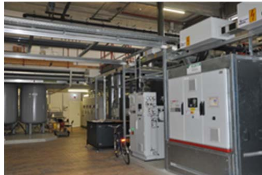
Abb. 1: Foto eines Teils der Versorgungszentrale für das Areal der Hochschule für Polizei in Biberach
