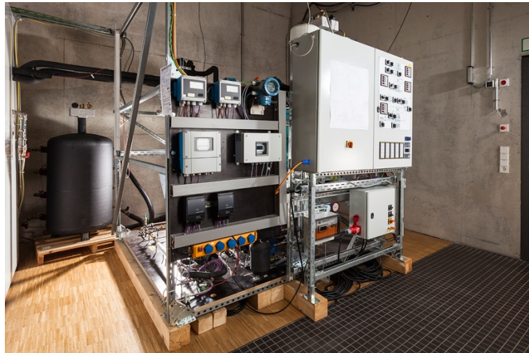
Bild 2: Laborkältemaschine der Hochschule Biberach
