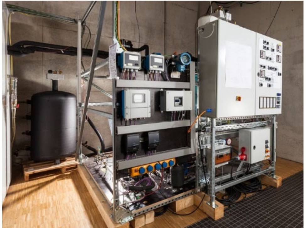
Bild 2: Laborkältemaschine der Hochschule Biberach
