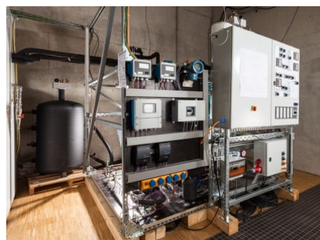
Bild 2. Laborkälteanlage zur Untersuchung von verbesserten Betriebsstrategien
