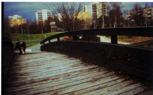
Abb. 5: Ungeschützte Trogbrücke Totalschaden nach 10 Jahren
