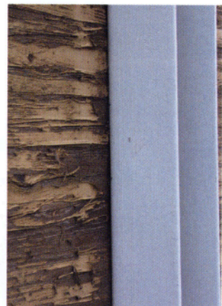
Abb. 2: Trogbrücke ohne baulichen Holzschutz. Stark abgewitterter Anstrich.
